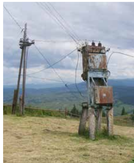
◀ Rozvod elektrické energie v horských oblastech někde ještě pamatuje sovětské časy.
